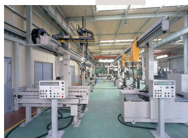
[平成7年] ガントリーローダー、天吊りロボット システム YGR-100C, YGR-15D
